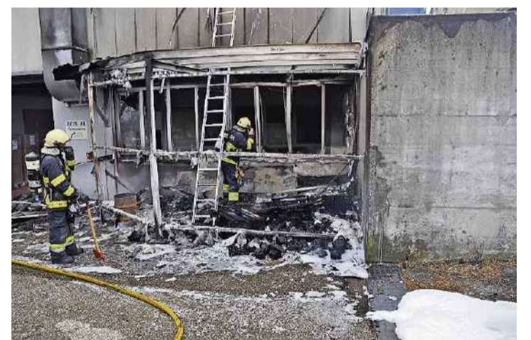
Möglicherweise die Folgen einer Brandstiftung.
